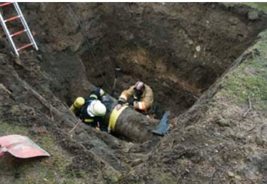
Feuerwehr und NBB dichteten gemeinsam das Leck ab.
